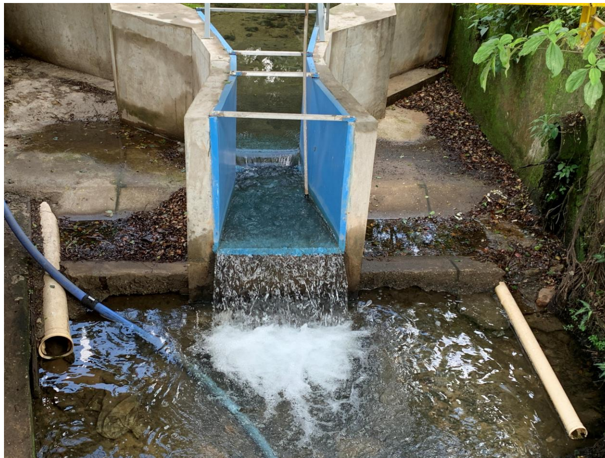
DEGRAU NA SAÍDA DA CALHA
